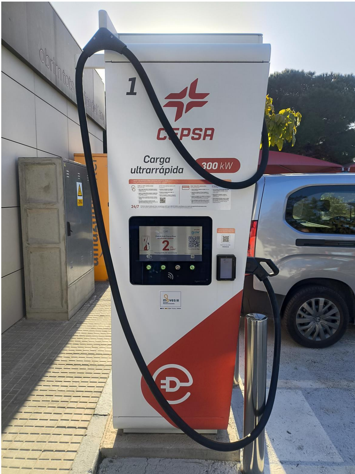
Frontal cargador 300 kW ES CASTELLDEFELS
